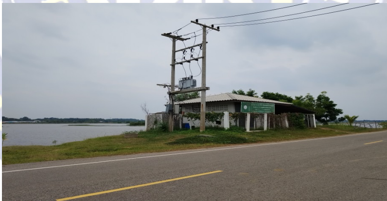
ภาพที่ 3 สถานีสูบน้ำด้วยไฟฟ้า (2565)
